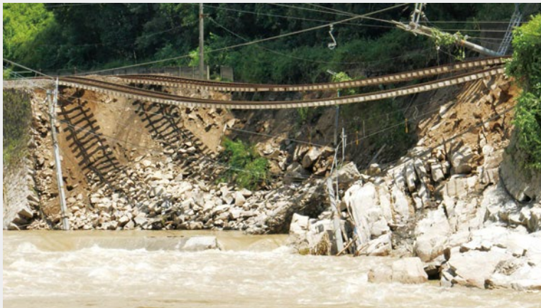
2018年7月由于暴雨导致的铁路塌陷 (东广岛市内)
